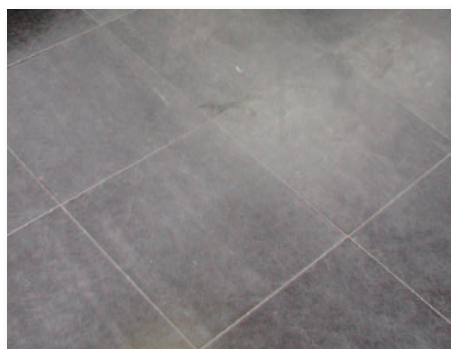
Afb. 3 Slijtage van een keramische tegelvloer.
