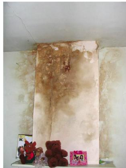
Vochtige schouwen verstoren een vlotte afvoer van de rookgassen en creëren daardoor een verhoogde kans op een slechte verbranding in het aangesloten toestel, met risico op CO-vergiftiging als gevolg.
