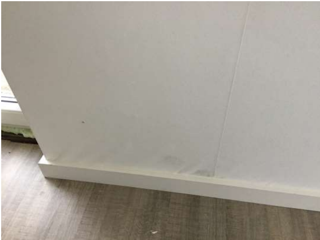
Zicht op schimmelvorming binnenmuur
