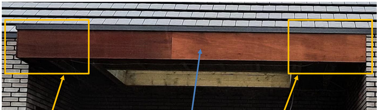
Foto 2 - Toestand in december 2020 – platen zijn flink nat door aanhoudende regen
